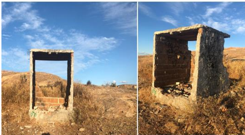
Figura 7: Capela em estado deteriorado no inselbegue Serrote Pedra de Chico Cirilo.
