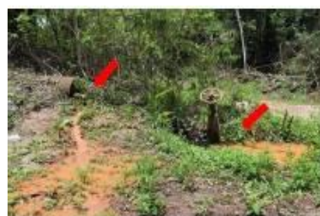
Figura 4- Ponto de lançamento da tubulação irregular
